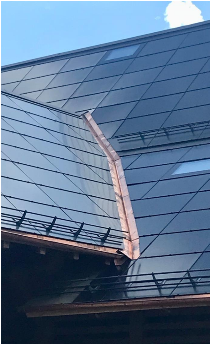
pannelli fotovoltaici della ditta 3S – Swiss Solar Solutions AG – photo credits: Elena Lucchi
