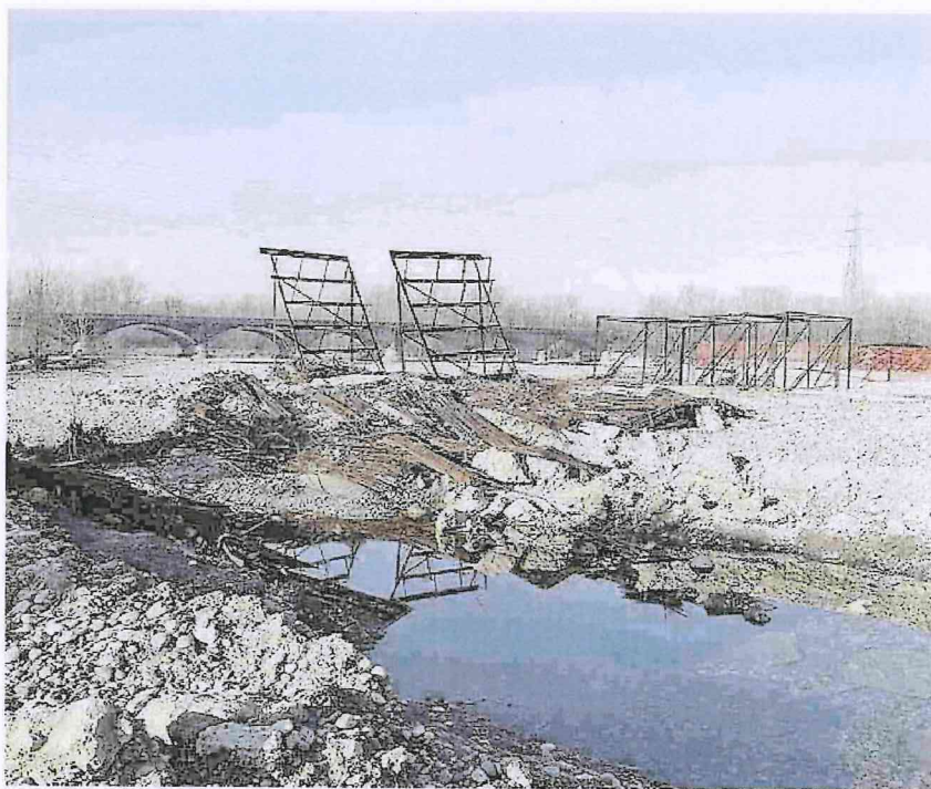
Il cantiere sul letto del fiume è abbandonato da mesi
