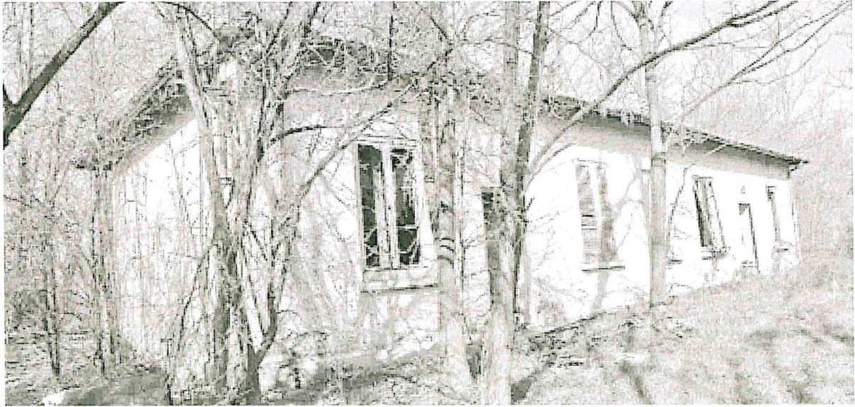
La ex Polveriera di via San Giovanni: bene di proprietà comunale, oggi è soltanto il regno del degrado e dell'abbandono
