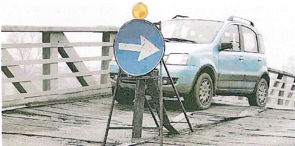
Il fondo stradale sconnesso con le lamiere pericolosamente ritorte sul ponte delle Barche
