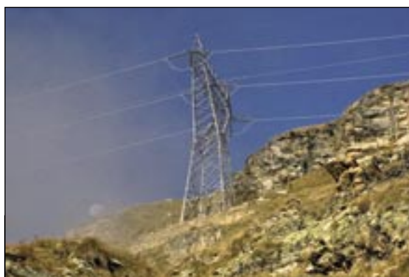
L'impatto delle linee elettriche sull'avifauna è un fenomeno ormai noto e riguarda soprattutto le specie di grandi dimensioni come ad esempio i rapaci diurni e notturni (Foto di P. Bonazzi).
